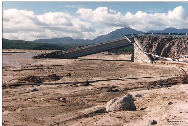
Fotografía 13. Erosión y destrucción del puente Chileno, por la tromba del 3 de noviembre de 1993 “gran diluvio” (Fotografía de Dr. Hugo Francisco Payén Izábal, de Raíces Cabeñas AC).
