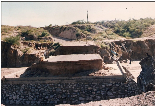
Fotografía 14. Erosión y destrucción del puente Palmilla por la tromba del 3 de noviembre de 1993 “gran diluvio”. Hacia la derecha, actualmente se encuentra un campo de golf (Fotografía de Dr. Hugo Francisco Payén Izábal, de Raíces Cabeñas AC).
