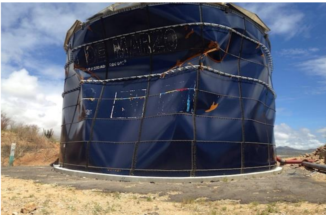
Imagen 3. Daños a la infraestructura física ocasionados por Odile.
